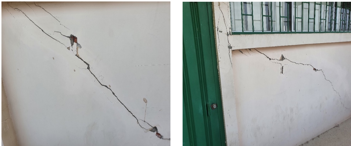
Figura 1: Fisuras en mampostería de ladrillo artesanal. Fuente: (Archivo personal, bloque de aula (UTM 2022)).
