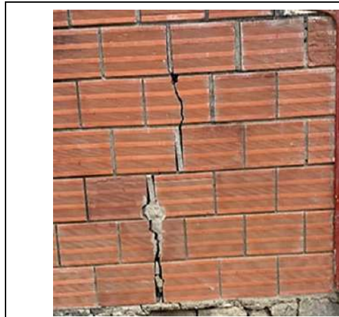
Figura 21. Pared de la vivienda 13
