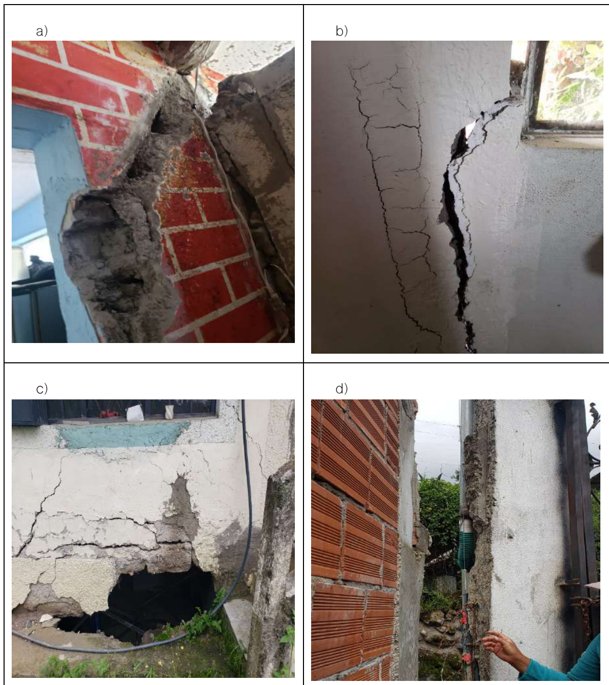
Figura 15. a) Falla a tracción originada por ausencia de columna confinante en la esquina de los muros, b) La falta de una columna de amarre ha generado una falla por tracción diagonal en la fachada, resultando en grietas severas y un significativo desplazamiento de las piezas rotas de esa pared, c) Colapso de parte del entepiso y el muro del nivel de suelo, d) Desprendimiento total de una columna que sostiene una puerta metálica, se evidencio ausencia de anclajes.
