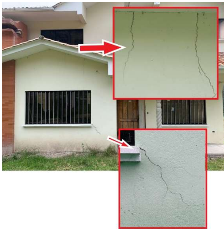
Figure 13. Casa 17. Detalle de fisuras en vivienda esquematizada.
