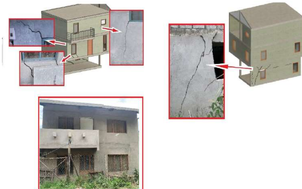
Figura 12. Casa 16. Detalle de fisuras en vivienda esquematizada.
