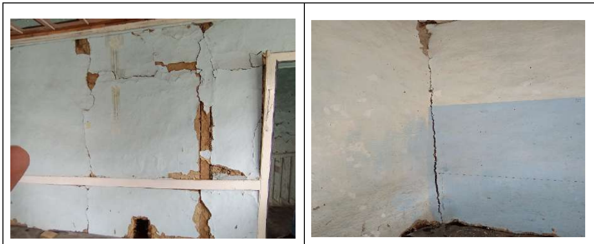
Figura 5. Casa 8. Quinta “San José” la imagen muestra una pared de tapial antigua, evidenciando daños, algunos de los cuales se atribuyen al sismo reciente. La visita, realizada en colaboración con el departamento de gestión de riesgos del GAD Municipal de Azogues
