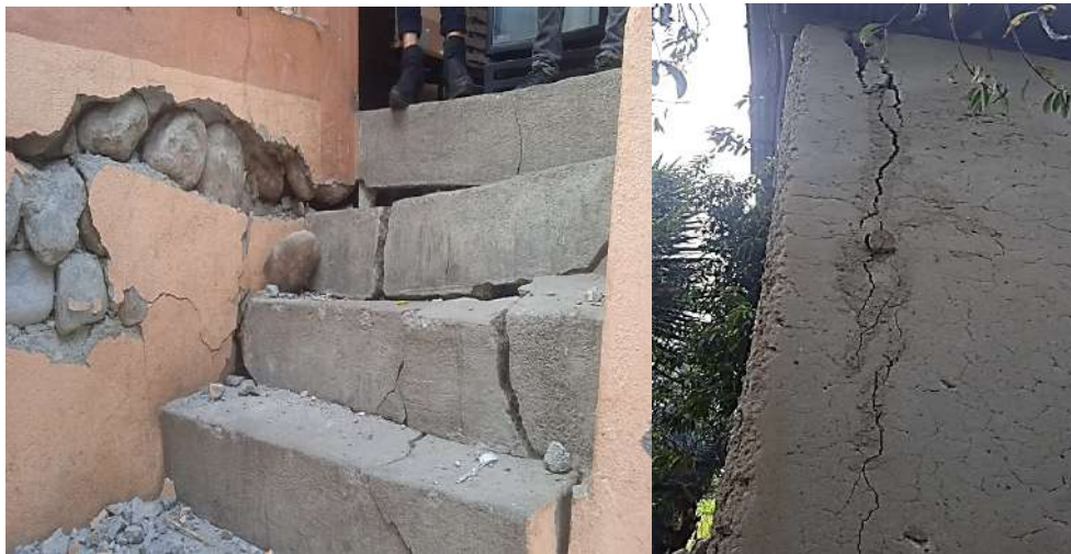
Figura 7. Casa 11. Daños en muros y escaleras.
