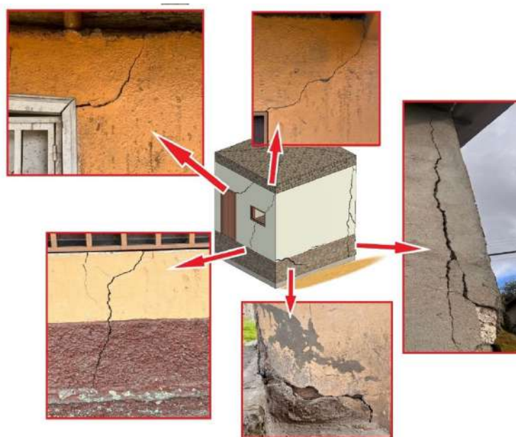
Figura 6. Casa 9. Detalle de fisuras en bodega.
